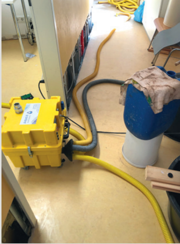
Trockengeräte versuchen, die Nässe aus den überfluteten Praxisräume herauszuziehen.
