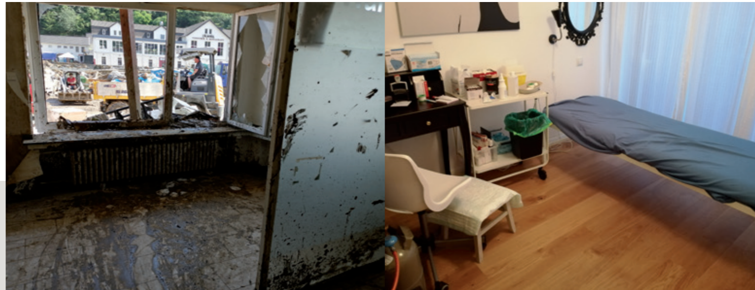
Wassermassen haben die Praxisräume zerstört.
